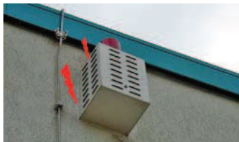
Bild 2: Zu geringer Trennungsabstand
