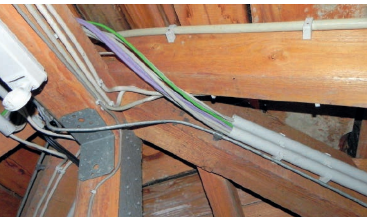
Nicht eingehaltener Trennungsabstand von Leitungen zu Blitzableiter
