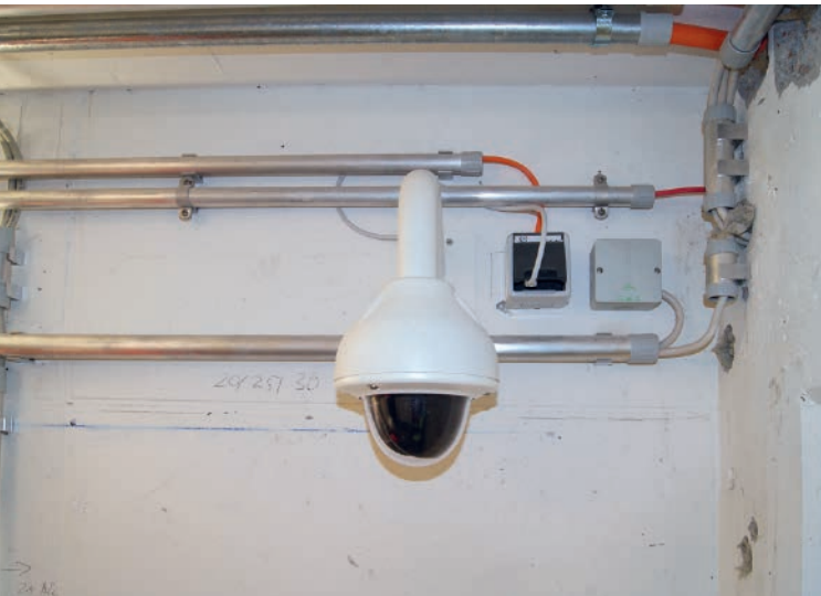
Kamera mit Vandalismus-schutz im Handbereich mit gepatchter Stecker-verbinding
